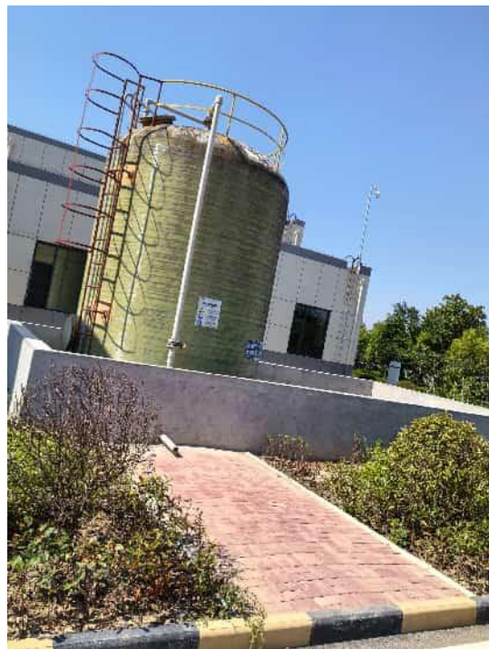
复合碳源罐区
