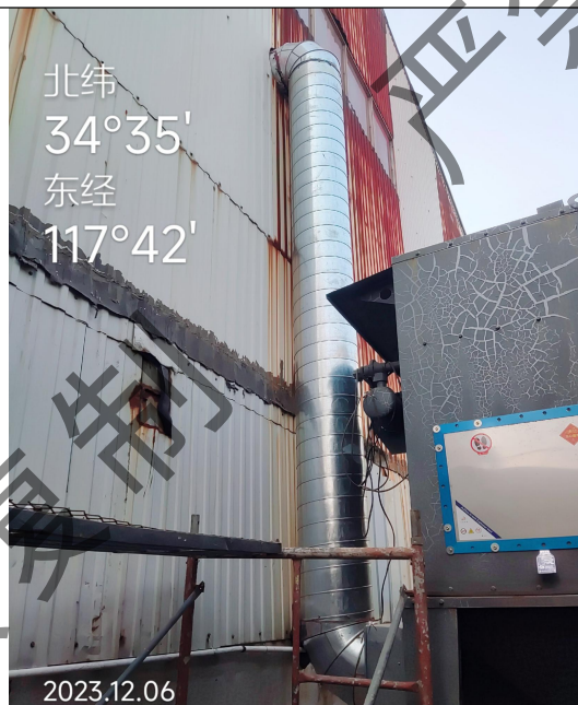
喷塑废气处理设施进口
